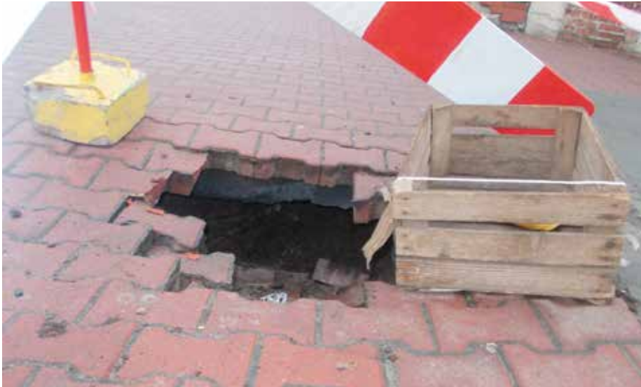
Dziura w chodniku przy jednej z ulic na terenie naszej Dzielnicy. Fot. Mateusz Drożdż
